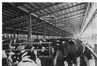
OS(直下型)換気扇を設置した 肥育牛舎
