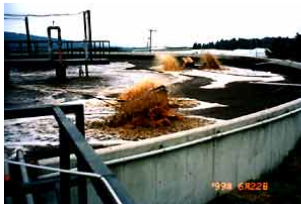
曝気中の曝気式ラグーン法の浄化槽
