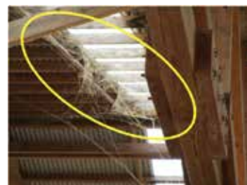
写真5 牛舎の天井のくもの巣
